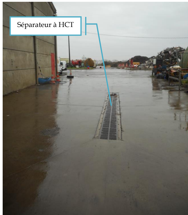
Figure 19 : Séparateur à hydrocarbures de la station de lavage et de l'aire de distribution de carburant
